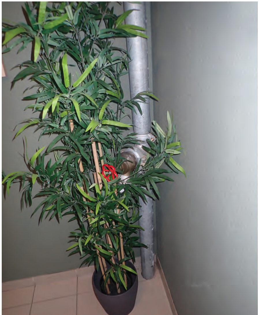
Winters: "Bewoners die een lelijke brandblusser in een gang afdekken door een grote plant is begrijpelijk, maar het levert een gevaarlijke situatie op"
