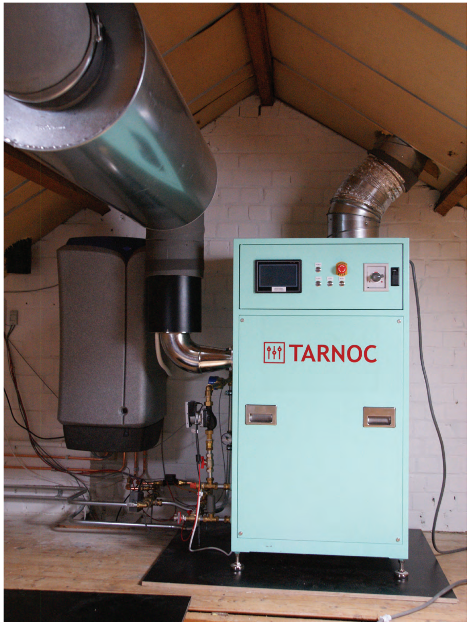
Opstelling van de Tarnoc-ketel in de testwoning
